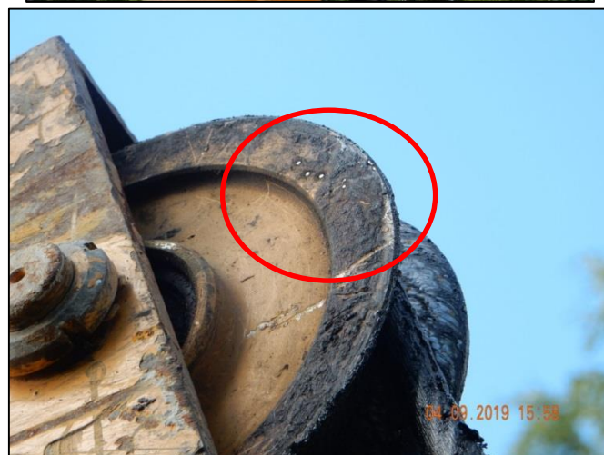
Место замыкания ВЛ-10 кВ л. 282-08 на металлоконструкцию БКМ
